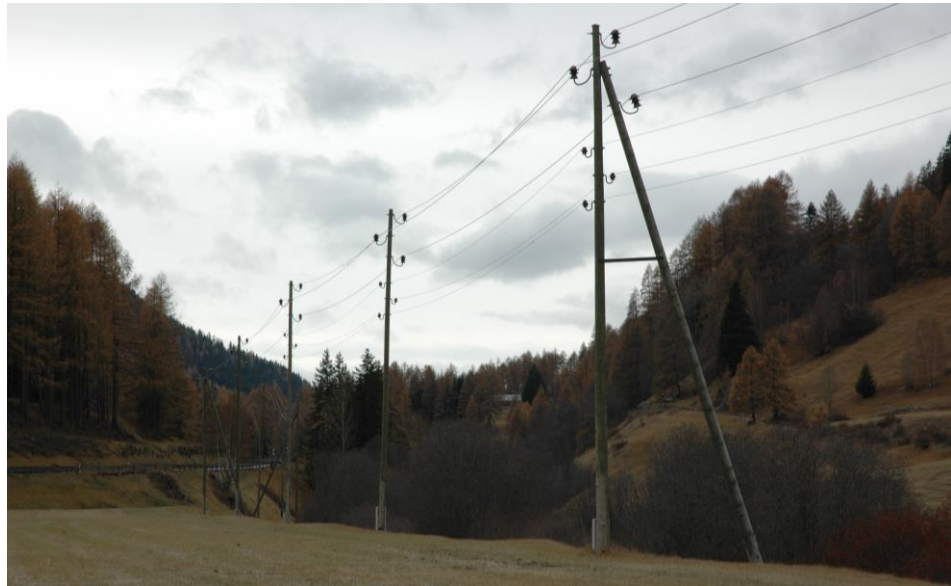
Abb. 7.1 60 kV- Leitung PRADELLA – BEVER bei Zernez.
