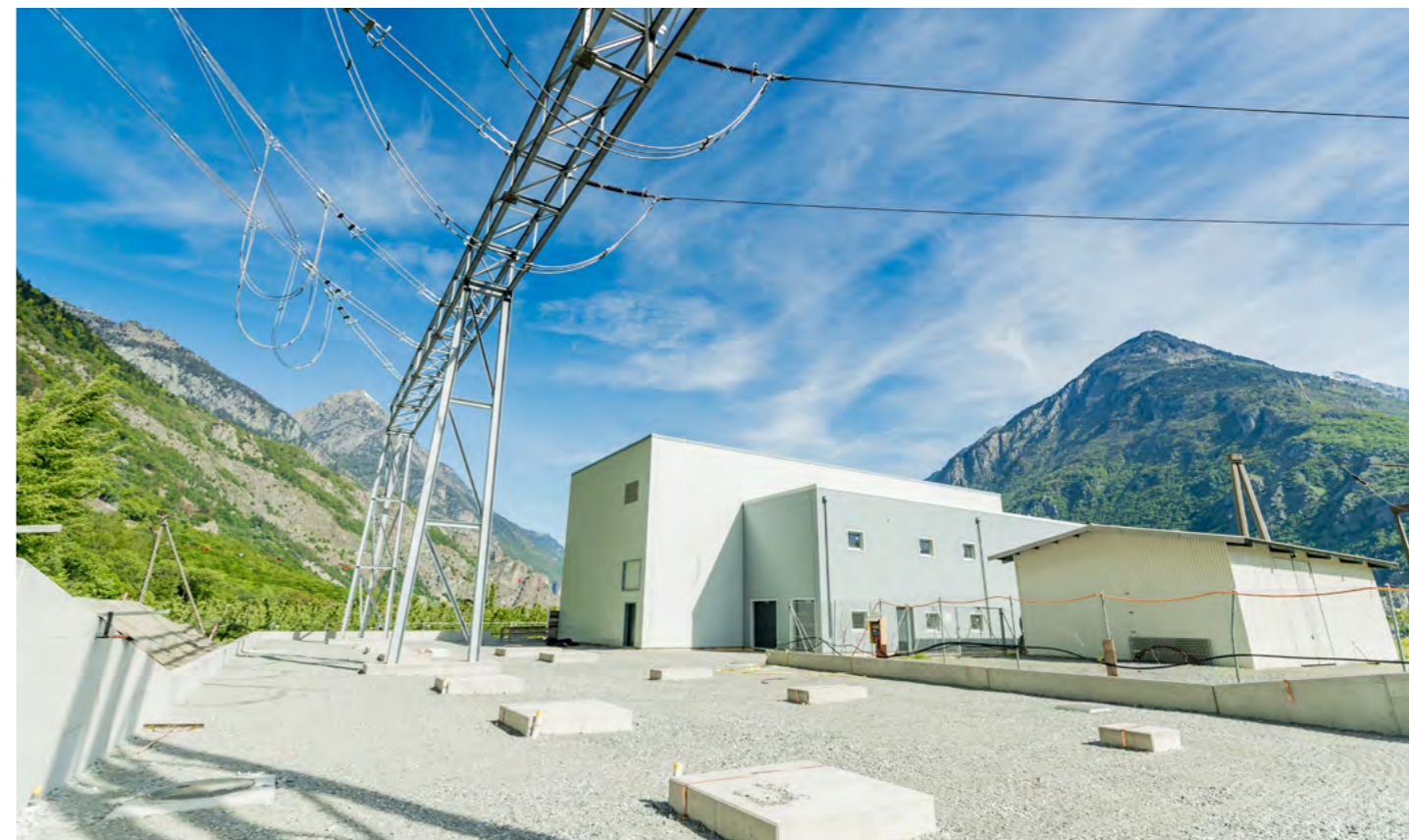
Poste électrique de La Bâtiаз, mai 2017
