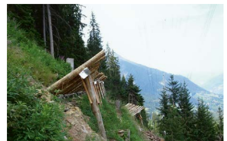
Die Schutzmassnahmen wurden in verschiedenen Öffnungen im Wald entlang des Leitungstrassees gebaut.
