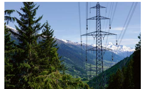
Die neue Höchstspannungsleitung zwischen Ernen und Ulrichen ist in Betrieb.
