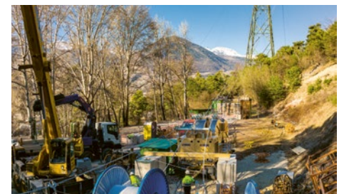
Place de tirage, pylône 142, Sion, mars 2022
