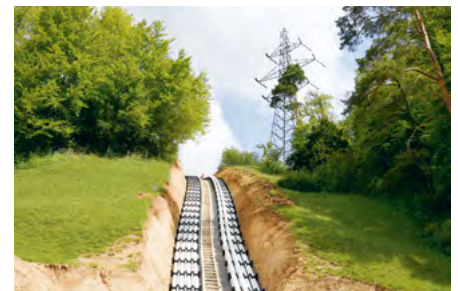
«Königsetappe» beim Bau des Kabeltrassees: Das steile Gelände auf der Höhe des Schryberhofs zwischen Bözbergstrasse und SBB-Linie ist ein anspruchsvolles Terrain.
