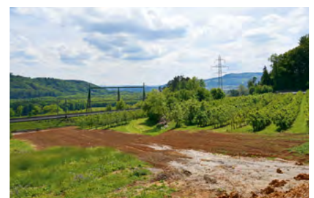
Unterhalb des Steilhangs bis und mit Unterquerung der SBB-Linie sind die Tiefbauarbeiten bereits abgeschlossen. Der Kabelgraben ist wieder zugedeckt, der Tunnel unterhalb der Gleise fertiggestellt. Im Hintergrund ist das Übergangsbauwerk Süd ersichtich.
