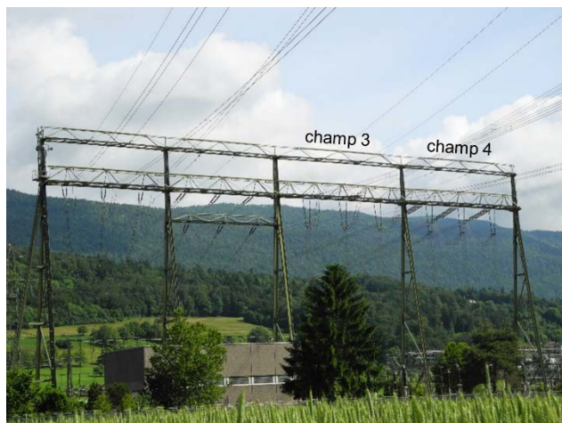
Portique SST PIE existant
