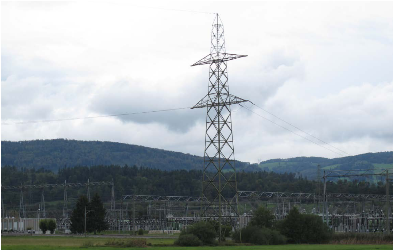
Pylône n° 140-2: conçu pour un terne 380 kV et un lacet CFF, équipé de la LT 132 kV Biel – Delémont
