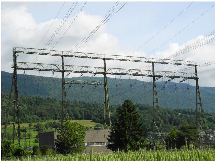
Portique sous-station de Pieterlen (état actuel)
