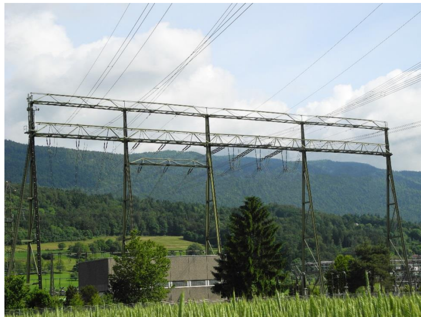
Portique sous-station de Pieterlen (état prévu)
