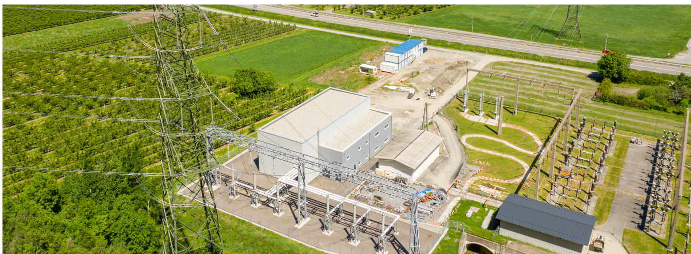
Exemple d'un poste de couplage isolé au gaz : la structure compacte permet de réduire d'environ un tiers la surface de terrain nécessaire.
