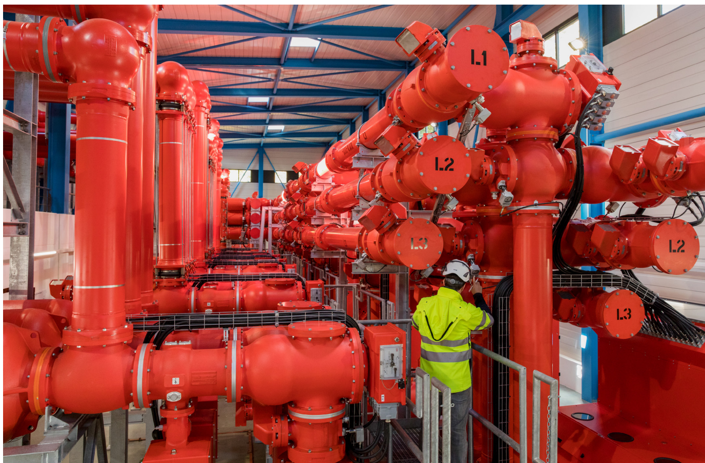
Vérification à Romanel de la pression d'une chambre du poste de couplage 220 kV isolé au gaz
